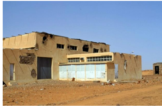
ポリサリオに砲撃されたあとが生々しい発電所
